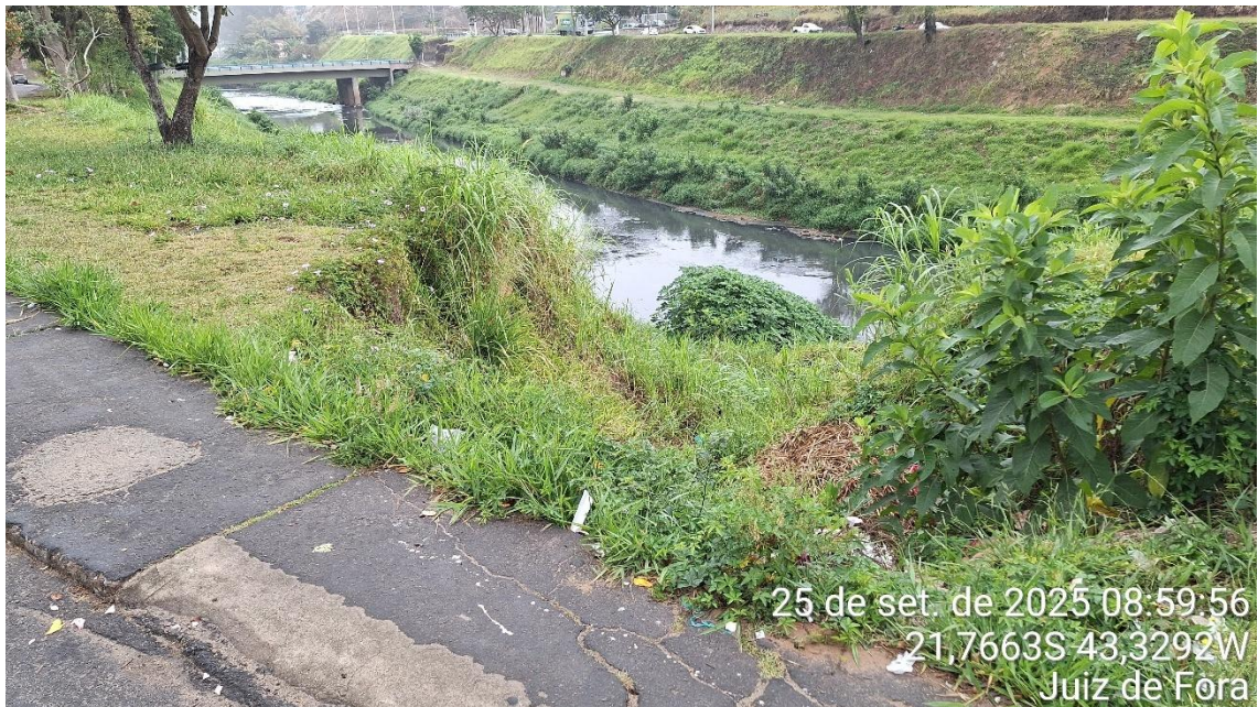
Foto 8 - Erosão hídrica na superfície do talude, indicada em azul na Foto 5.
