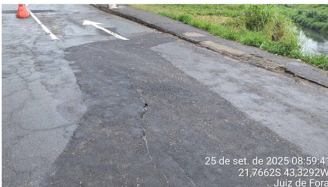
Foto 17 - Fissuras e trincas no pavimento da Av. Brasil recentemente reparado.
