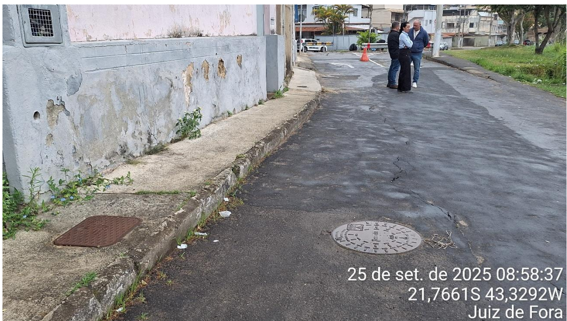
Foto 23 - Tampas de acesso às tubulações de água e esgoto localizadas entre as edificações e as fissuras e trincas.
