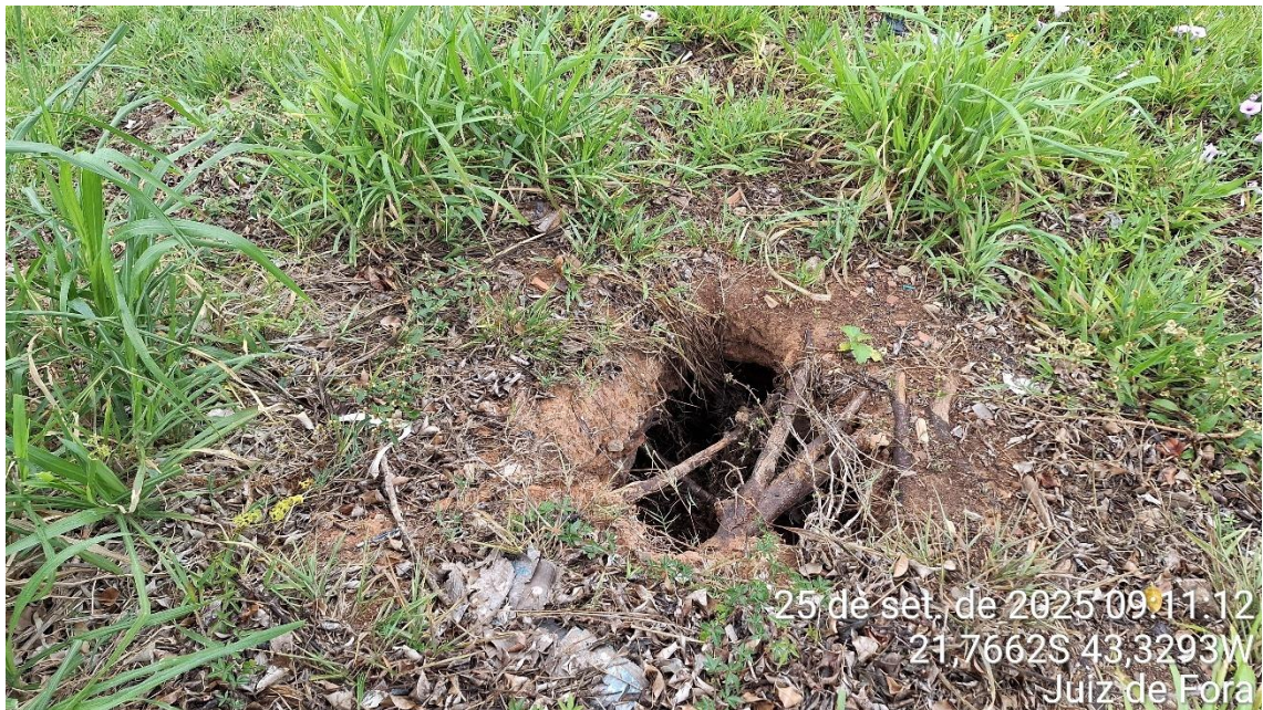
Foto 10 - Erosão tubular intestina (“piping”), cuja posição está indicada em vermelho na Foto 5.
