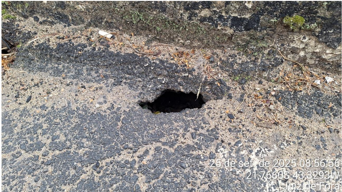
Foto 22 - Detalhe da cavidade junto à guia, potencial gatilho de formação de erosão tubular intestina (“piping”).
