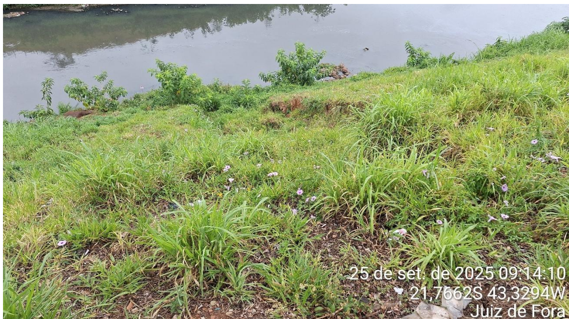
Foto 6 - Erosão hídrica na superfície do talude, indicada em amarelo na Foto 5.
