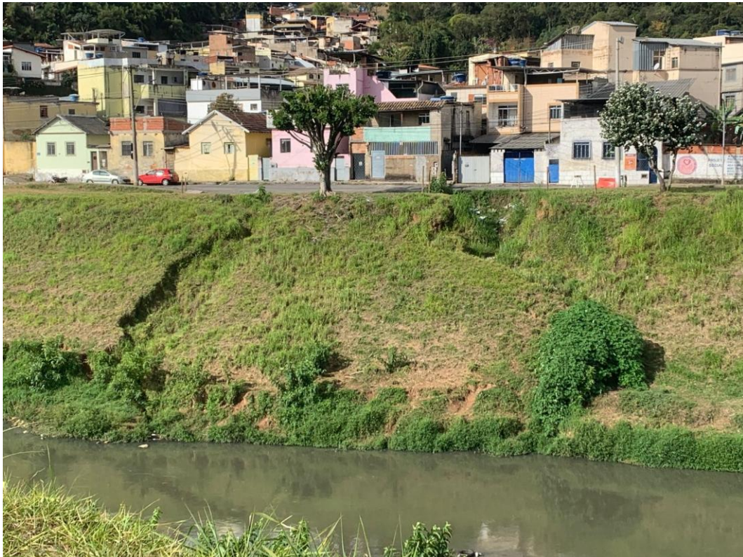
Foto 1-Vista do talude da margem esquerda do Rio Paraibuna (foto fornecida pela CESAMA).
