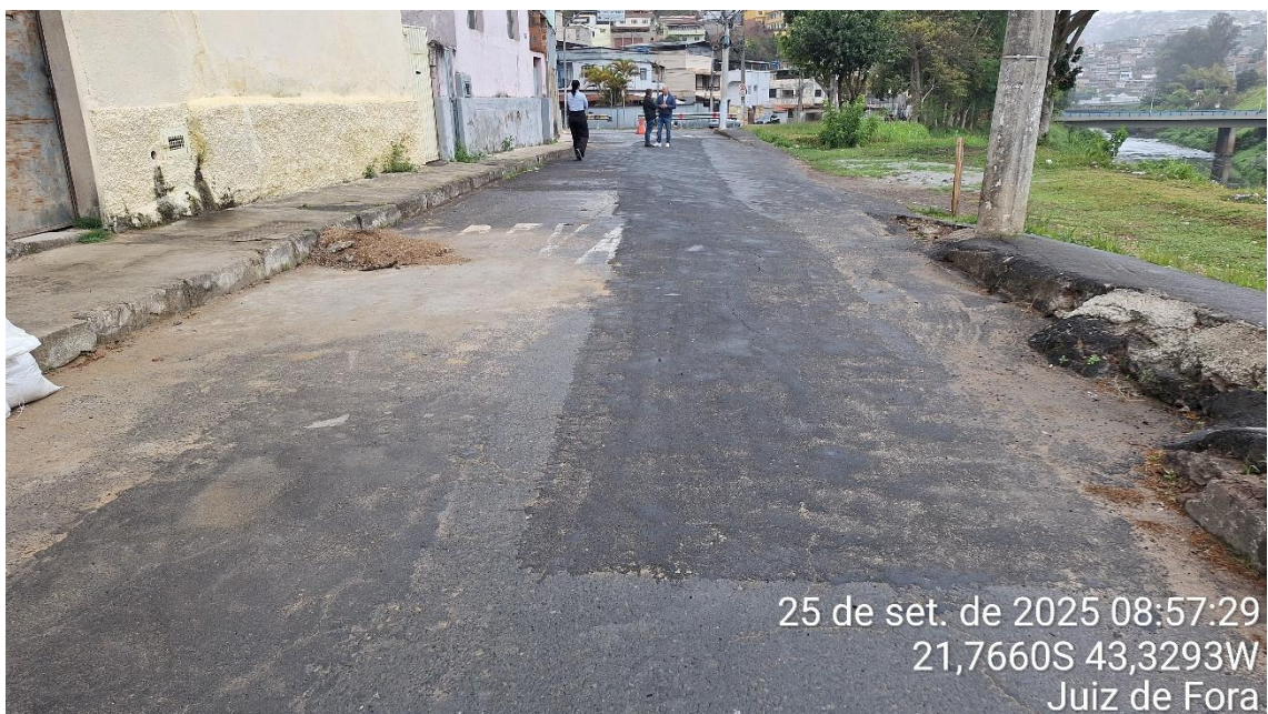
Foto 14 - Fissuras e trincas no pavimento da Av. Brasil recentemente reparado.
