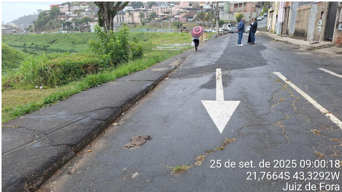
Foto 18 - Fissuras e trincas no pavimento da Av. Brasil recentemente reparado.
