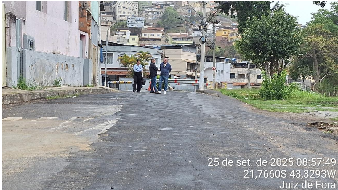
Foto 20 - Recalque da porção do terreno entre as fissuras e trincas e a crista do talude, com inclinação acentuada do pavimento a partir da trinca em direção ao rio.
