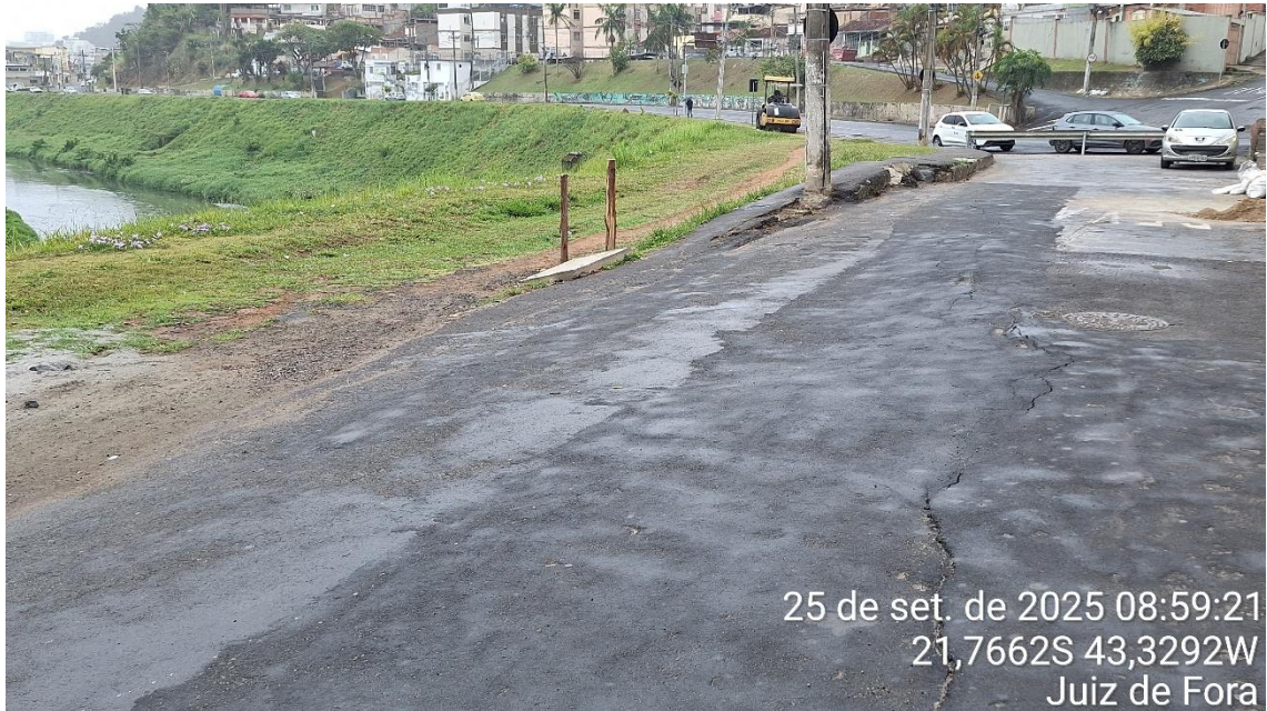
Foto 13 - Fissuras e trincas no pavimento da Av. Brasil recentemente reparado.
