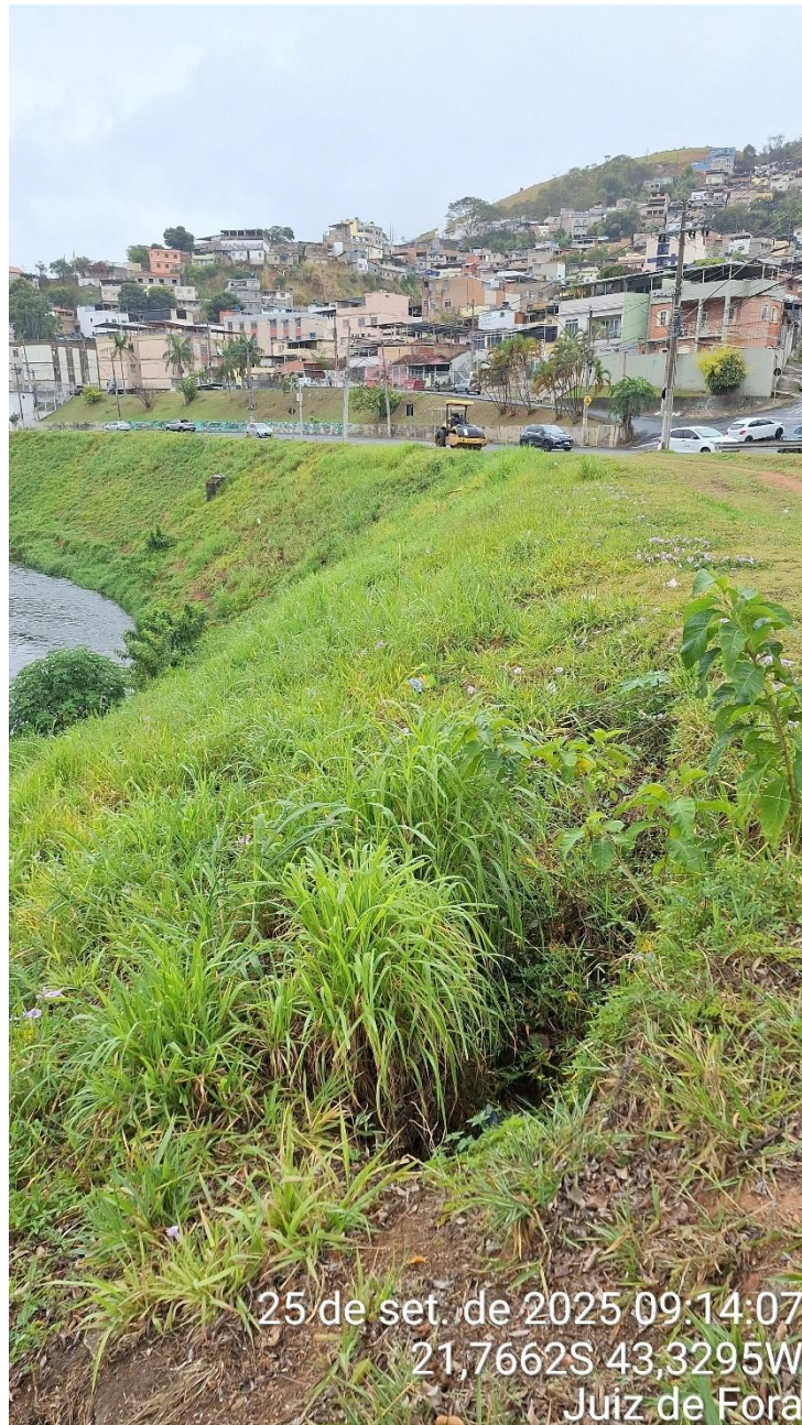
Foto 7 - Crista da erosão hídrica na superfície do talude, indicada em amarelo na Foto 5.
