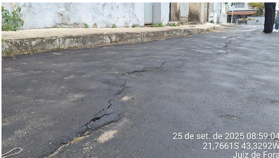
Foto 16 - Fissuras e trincas no pavimento da Av. Brasil recentemente reparado.
