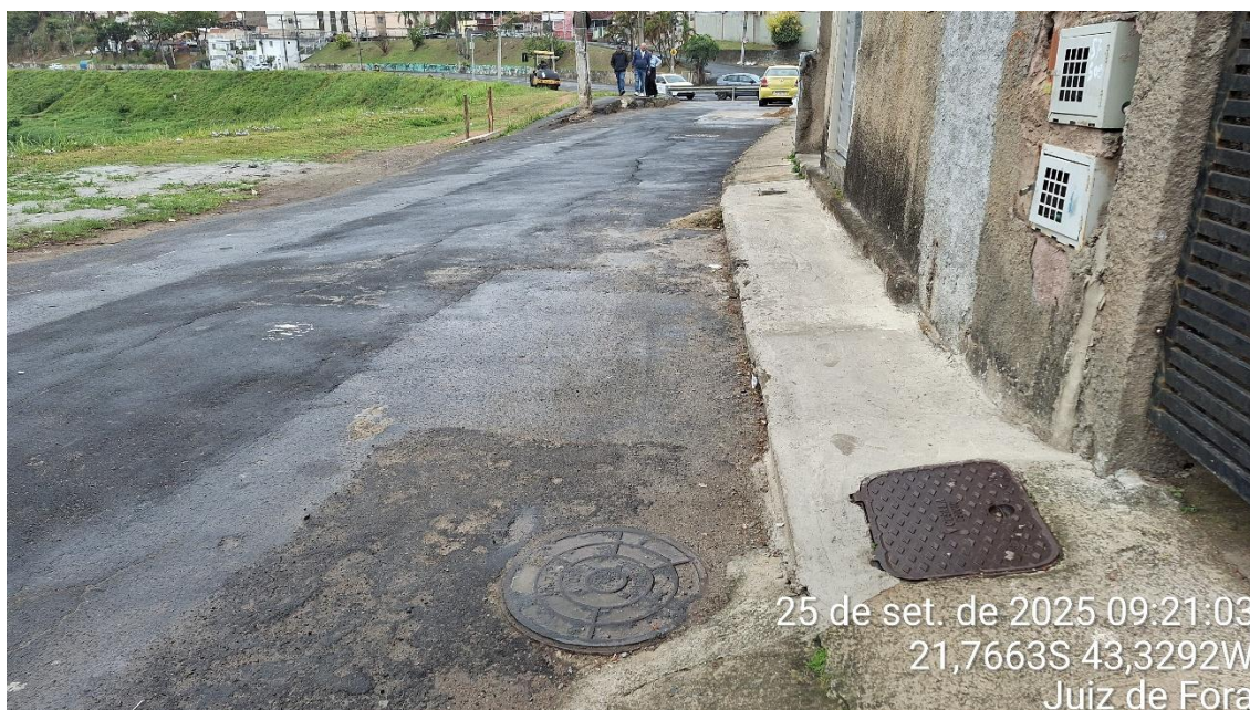
Foto 24 - Tampas de acesso às tubulações de água e esgoto localizadas entre as edificações e as fissuras e trincas.
