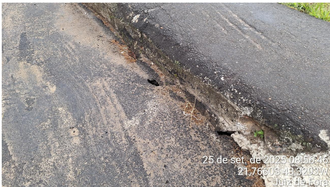
Foto 21 - Cavidades junto à guia, potenciais gatilhos de formação de erosão tubular intestinal (“piping”).
