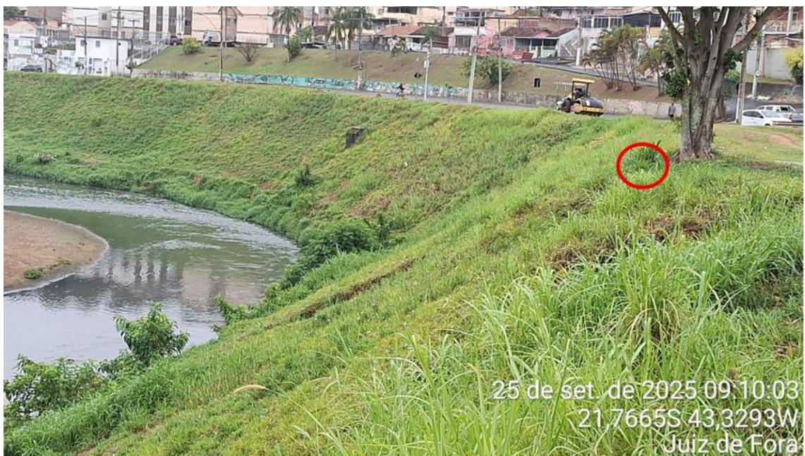
Foto 11 - Posição da erosão tubular intestina (“piping”) mostrada na Foto 10 indicada em vermelho.
