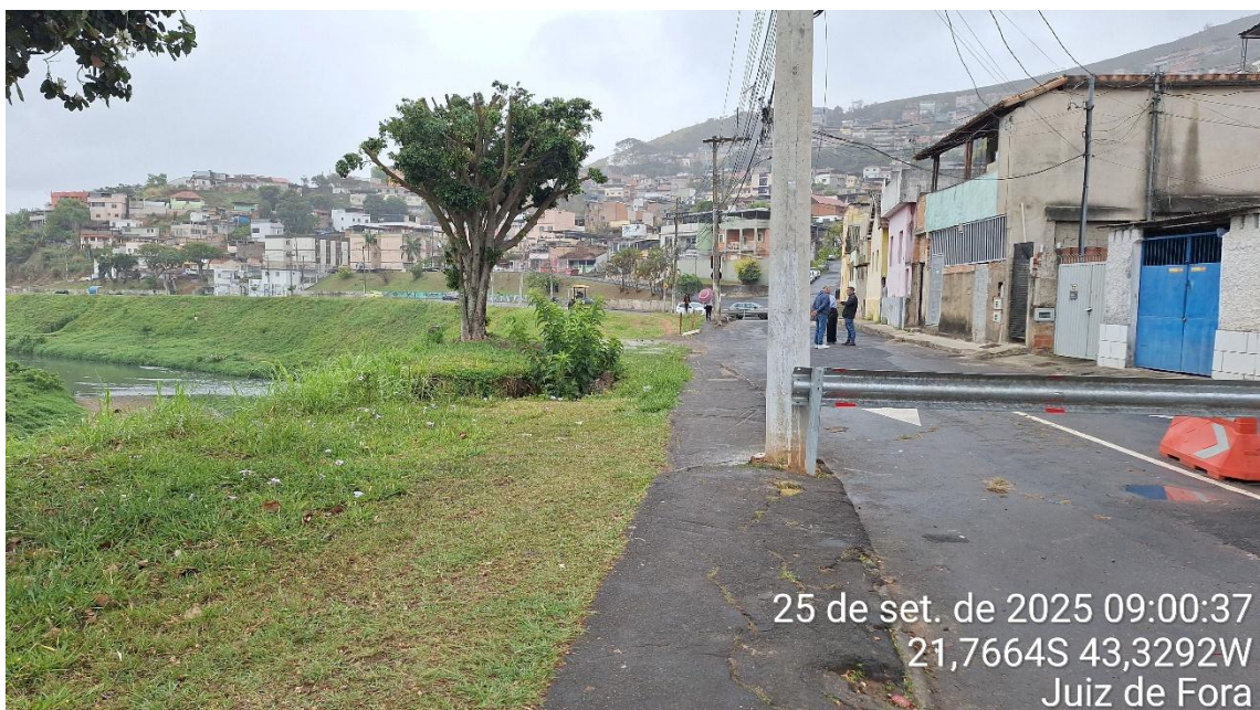
Foto 19 - As fissuras e trincas no pavimento da Av. Brasil foram observadas até o local de implantação do poste de energia.
