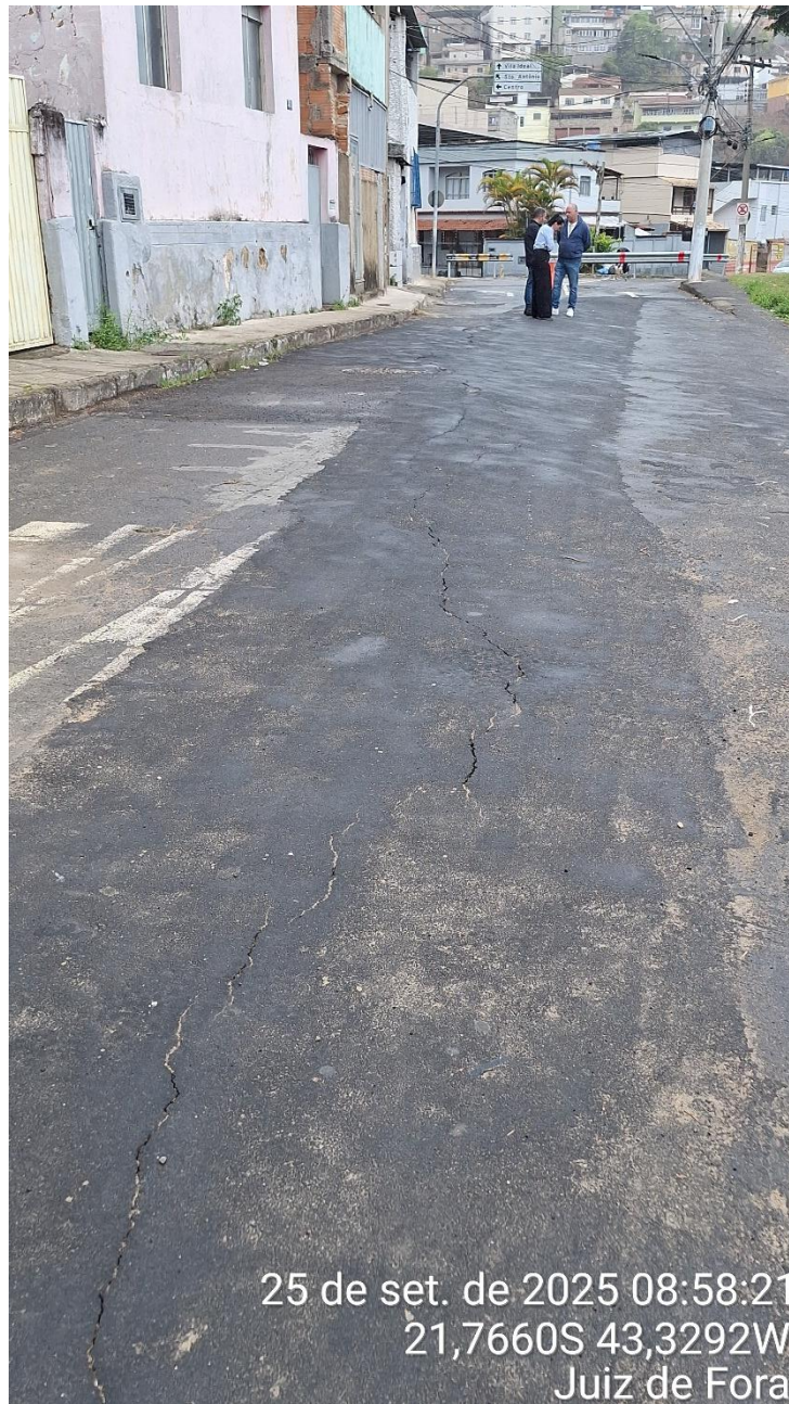
Foto 15 - Fissuras e trincas no pavimento da Av. Brasil recentemente reparado.
