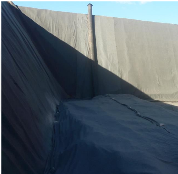
Foto 02. Drenos – testemunho e coleta de chorume
